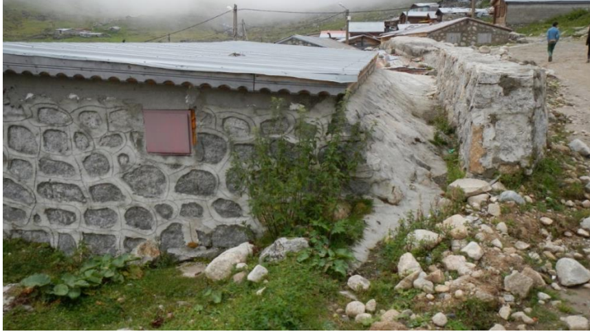
Şekil 2. Çığ gelen yüzü taş duvarla tahkim edilen yapılar
