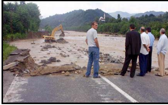
Foto 9. 20 Ağustos 2005 selinde Çamlıhemşin-Ardeşen yolunda oluşan hasar.
