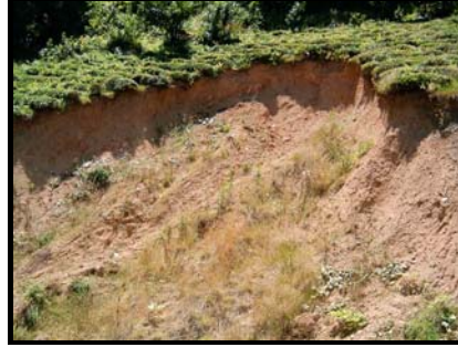
Foto 6. Çamlıhemşin Şenyuva mahallesinde heyelan
